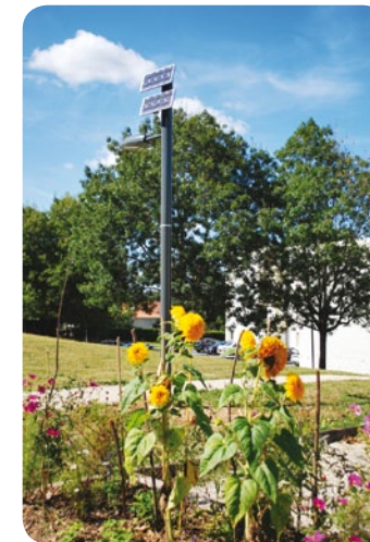
Six lampadaires photovoltaïques éclairent le chemin piétonnier à Pagot.
